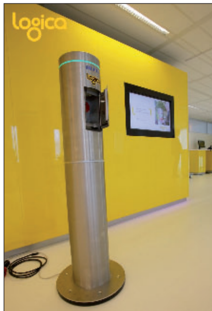
Laadpunt in het Logica Spark Center.
